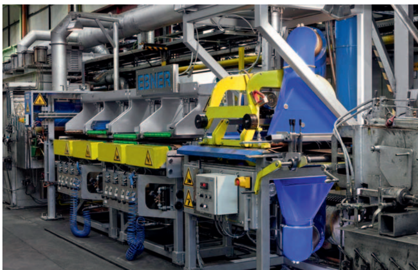
Produkce společnosti EBNER je postavena na zařízeních pro zpracování materiálů, rovnací linka.
